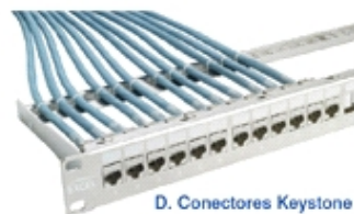
D. Conectores Keystone instalados en panel de conexiones cromado, nº de referencia 100-028
